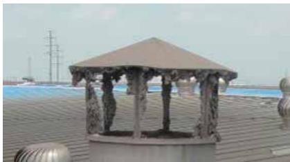
图 5 传统喷涂机废气排放方式导致烟囱顶盖、内壁粘附粉尘情况
