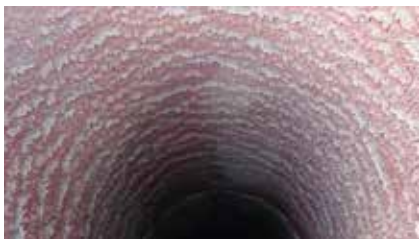
图 4 传统喷涂机排气管道内壁粘附化料情况
